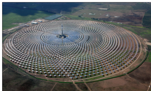
Obr. 1. První komerční termální solární elektrárna Gemasolar (letecký pohled)
