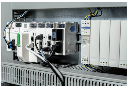
Obr. 1. ePAC Modicon M580 v rozváděči vodárny
