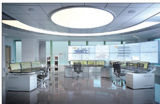
Obr. 1. Velín řídicího systému spalovny odpadů
