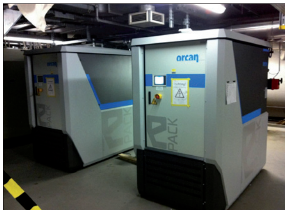
Obr. 2. Dva systémy ePack využívají odpadní teplo z průmyslového chlazení v průmyslovém podniku v Mnichově
