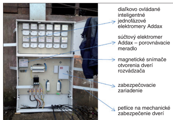
Obr. 2. Pohľad do rozvádzača v vchode bytovky
