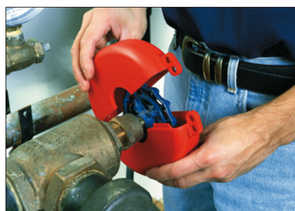
Obr. 2. Uzamknout lze také uzavřený ventil přívodu páry, horké vody apod.
