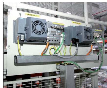
Obr. 3. Kompaktní měnič nejnovější generace Sinamics G120D-2 s krytím IP65 jako součást pohonu zdvihacího zařízení v útvaru montáže
