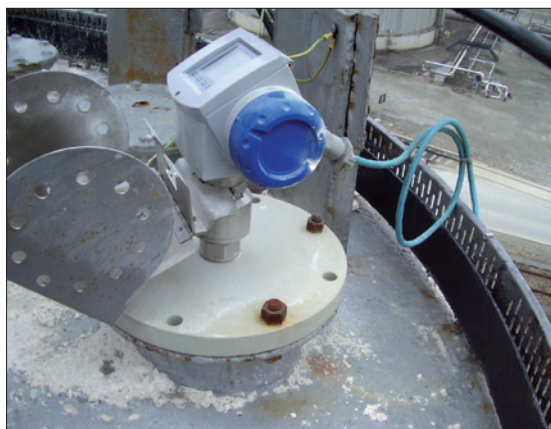
Obr. 1. Radarový hladinoměr s vedenou vlnou Optiflex 1300 C na síle pro skladování mletého vápence
