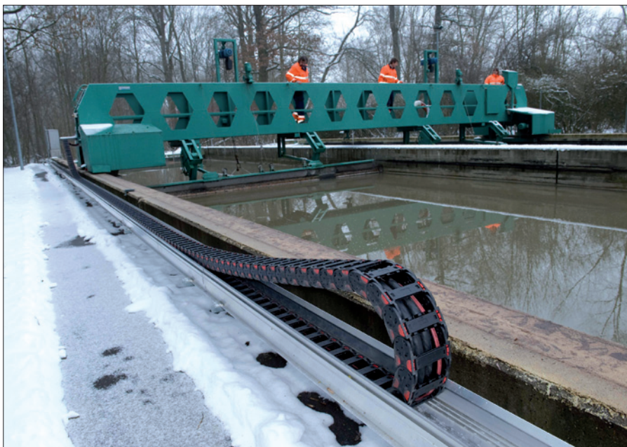
Obr. 2. Použití vodičích řetězů v čistírně odpadních vod v Nersingenu
