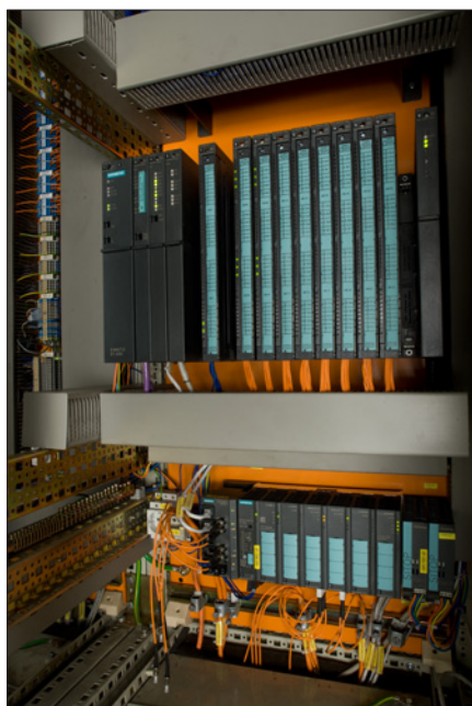
Obr. 4. Řídicí rozváděč s PLC Simatic S7-400 připojeným k primární redundanční gigabitové síti v úseku předběžného třídění přes přepínač Scalance X408-2 (dole vlevo)
