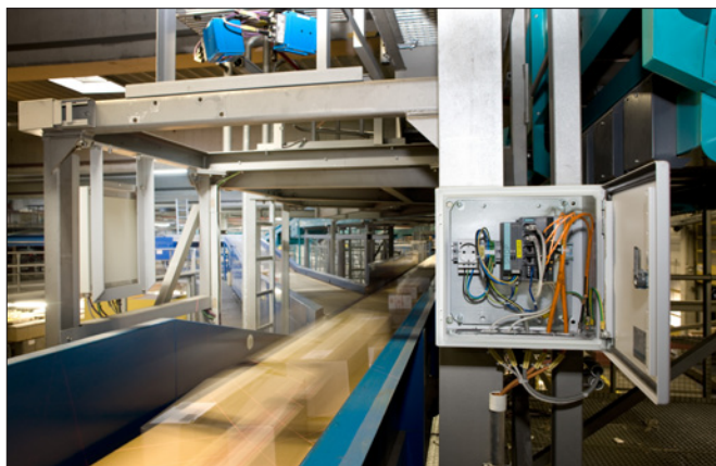
Obr. 5. Instalace přepínače Scalance X204-2 v sekundární kruhové síti (100 Mb/s) hlavní třídičky a nakládacích terminálů
