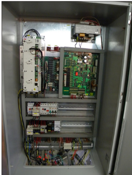
Obr. 1. Rozváděč výtahu s měničem frekvence ACSM1 Lift – modernizace výtahu v obytném domě v Břeclavi
