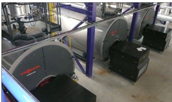
Obr. 1. Tři kotle Vitomex o tepelném výkonu po 6,5 kW
