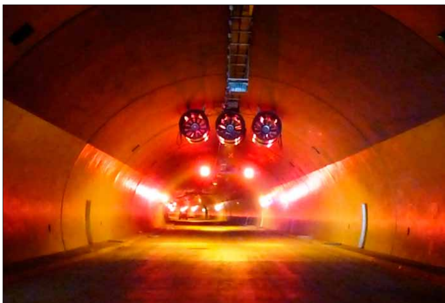
Obr. 1. Správná funkce proudových ventilátorů může výrazně ovlivnit následky požárů v silničních tunelech
