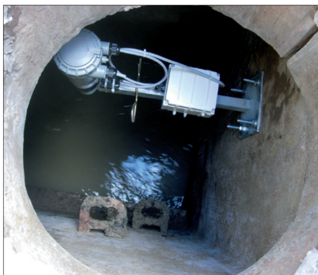
Obr. 4. Snímač BHV Echo 111 GSM instalovaný ve sběrné šachtě splaškových vod (vpravo od snímače je patrná skříňka s napájecí baterií)
