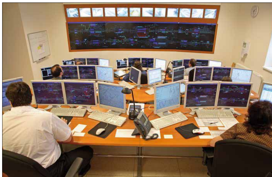
Obr. 2. Centrální dispečerské pracoviště v Přerově, z něhož je řízeno 174 km tratě
