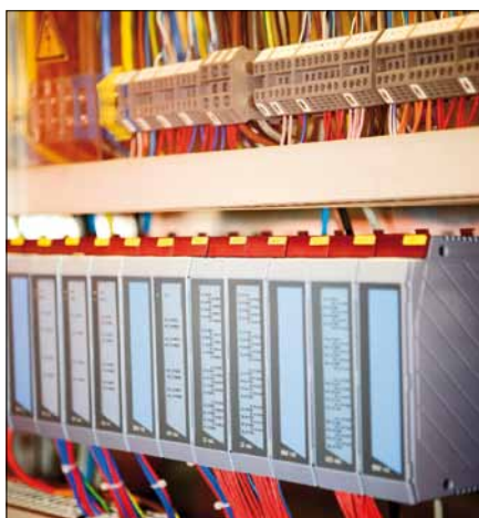
Obr. 1. Vnitřek jednoho z mnoha rozváděčů
