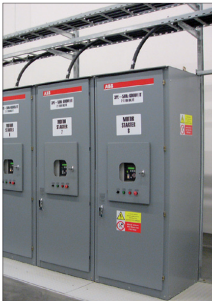
Obr. 1. Rozváděče ABB v závodě Hyundai v Nošovicích
