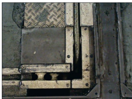
Obr. 1. Kabely v upínací desce: podmínky pro ně zdaleka nejsou ideální
