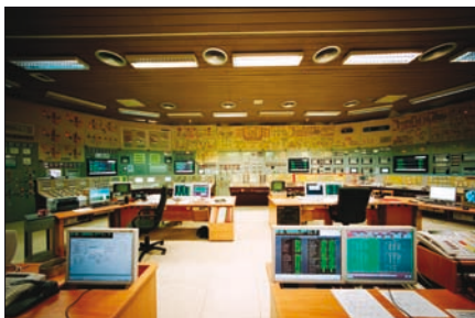
Obr. 32. Operátorská místnost v Jaderné elektrárně Dukovany - na rekonstrukci ŘS se podílela i společnost ZAT
