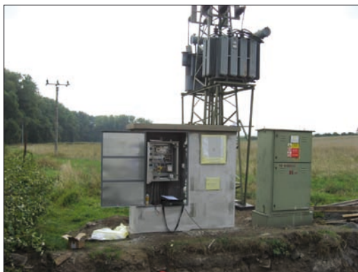
Obr. 3. Rozváděče nainstalované do zděného kiosku u čerpací stanice
