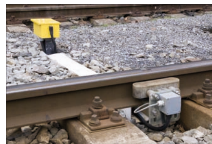
Obr. 3. Senzor a vysílač v kolejišti tvoří počítačící bod pro detekci náprav
