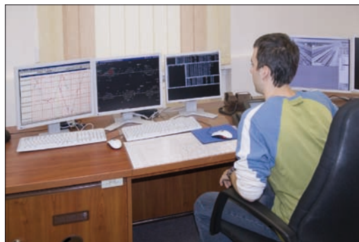
Obr. 4. Z jednotného obslužného pracoviště v České Lípě je ovládán celý úsek tratě
