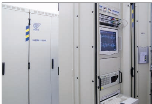
Obr. 2. Trať byla vybavena elektronickým stavědlem ESA 33
