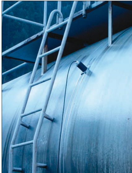
Obr. 2. Ultrazvukový snímač výšky hladiny E03 instalovaný na nádrži s propan-butanem
