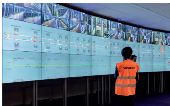
Obr. 1. Systém Trainguard MT CBTC se skládá z vlakové a traťové infrastruktury a řídicího centra
