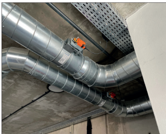
Obr. 6. Vzduchotechnika ve sklárně
