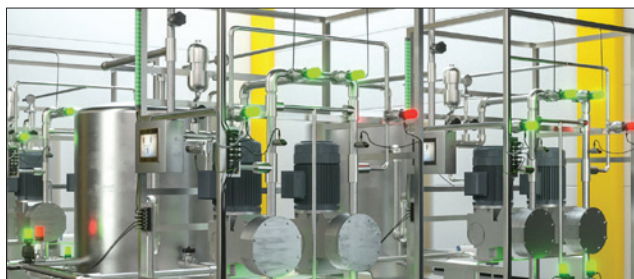
Obr. 6. V modulárních výrobních linkách pro farmaceutický průmysl se jednotlivé moduly (v provedení „skid“, vhodné pro umístění do standardního rámu a přepravu kontejnerem) sestaví a zapojí podle potřeby
