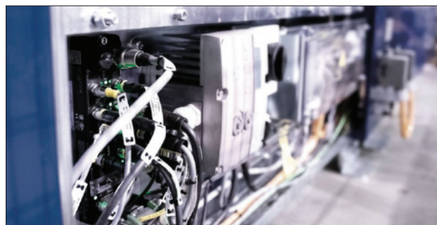
Obr. 3. Nakládací a vykládací systém, který je decentralně řízen robustními moduly Turck TBEN-L-PLC s krytím IP67, může pracovat i v prostředí mrazíren, protože rozsah jeho pracovních teplot začíná na -25\text{ }^{\circ}\text{C}
