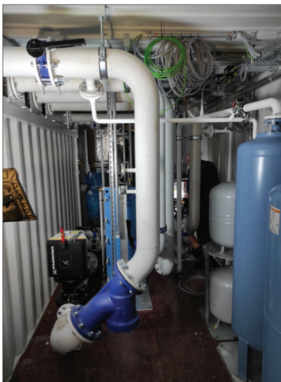
Obr. 2. Technická zařízení uvnitř kontejneru
