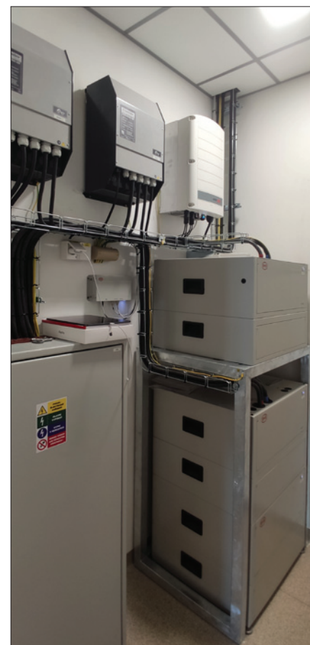
Obr. 4. Bateriové úložiště s kapacitou 46 kW·h od firmy BYD a střídač SolarEdge kombinovaný se dvěma hybridními střídači firmy Studer Innotech
