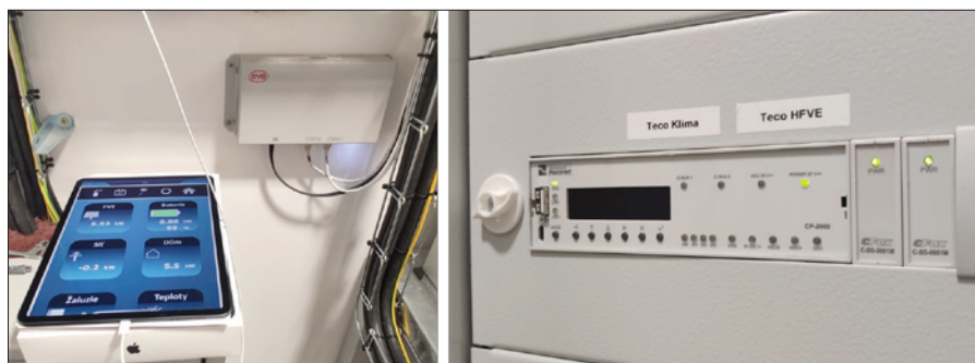
Obr. 6. Ukázka z technické místnosti: vlevo iPad pro interaktivní přístup k řízení energetiky a TZB celé budovy, vpravo detail centrálního modulu CP-2000 Tecomat Foxtrot
