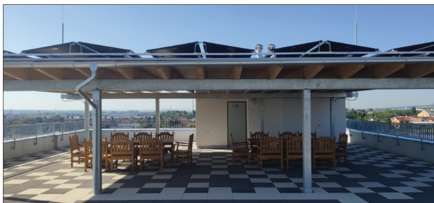
Obr. 3. Fotovoltaické panely s kombinovaným směřováním východ-západ jsou instalovány „neviditelně“ na altánu zastřešujícím prostor k posezení i jednání s výhledem na kompletní brněnské panorama
