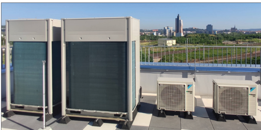
Obr. 5. Venkovní jednotky VRF od firmy Daikin zajišťují chlazení a topení ve 22 kancelářských místnostech (v pozadí brněnské dominanty – AZ Tower, Špilberk a Petrov)
