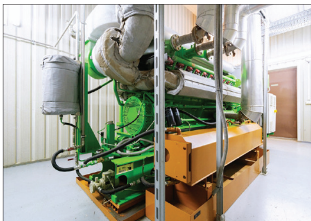
Obr. 1. Kogenerační jednotka bioplynové stanice v ZOD v Mrákově
