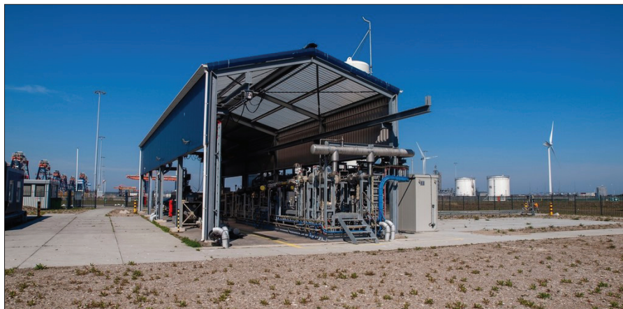
Obr. 1. Kalibrační zařízení nizozemského metrologického institutu VSL pro měření průtoku LNG bylo vybaveno měřicí technikou od společnosti Endress+Hauser (zdroj: Endress+Hauser)
