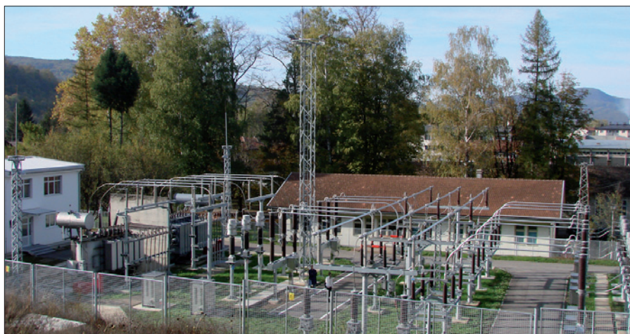
Obr. 1. Rozvodna Kotor Varoš v Bosně a Hercegovině
