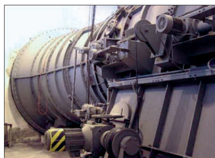
Obr. 1. Důlní ventilátor v HBP Prievidza, jehož pohon je řízen měničem frekvence Vacon NXc
