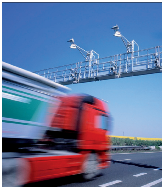
Obr. 1. Mikrovlnné antény namontované na portálech nad dálnicemi zajišťují spojení mezi palubními jednotkami v užitkových vozidlech a výpočetními mýtnými stanicemi u dálnice (zdroj: Kapsch TrafficCom)
