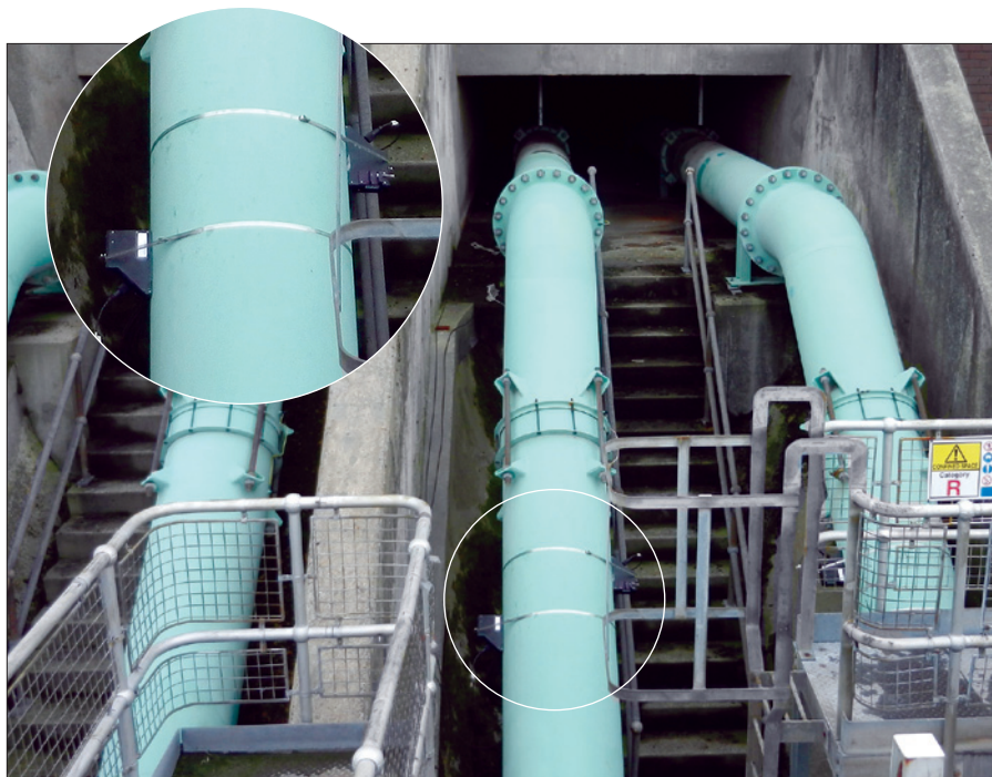
Obr. 1. Senzory příložného průtokoměru Sitrans FST020 instalované na potrubí v čerpací stanici odpadních vod (zdroj: Welsh Water)
