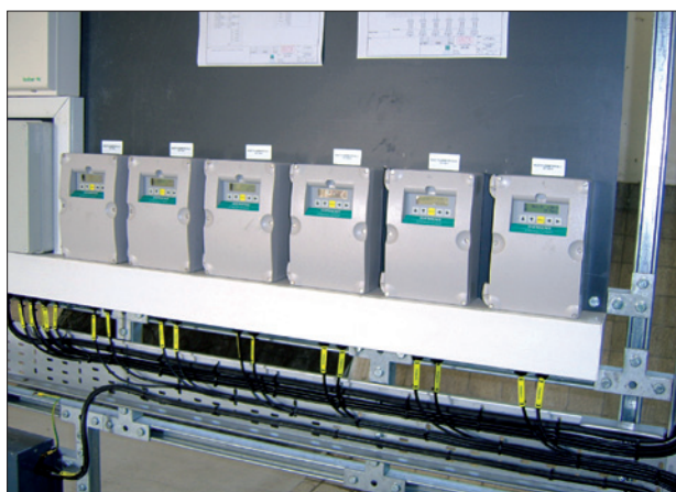
Obr. 2. Skupina řídicích a vyhodnocovacích jednotek systému Sitrans FST020 s odečtem na dálku v čerpací stanici odpadních vod (zdroj: Welsh Water)
