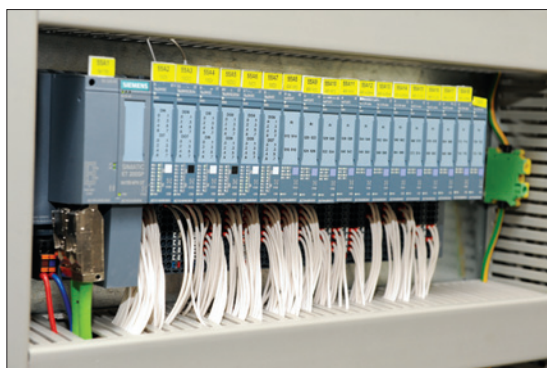
Obr. 2. Jedna ze sestav distribuovaných periférií Simatic ET 200SP instalovaných ve sladovně
