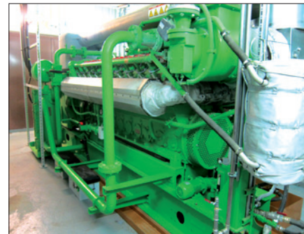
Obr. 4. Spalovací motor (24 válců) kogenerační jednotky uzpůsobený pro spalování bioplynu (výrobce GE Jenbacher)
