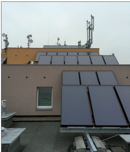
Obr. 1. Pohled na část pole solárních kolektorů na střeše bytového domu
