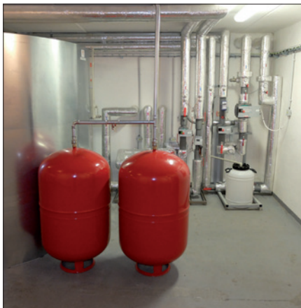
Obr. 2. Teplo ze solárních panelů je „uskladňováno“ v akumulaciční nádrži o objemu 8 700 l (vlevo)
